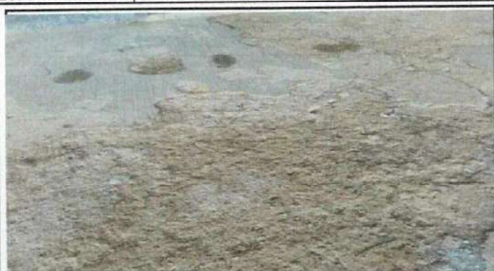
Foto1: el piso de esta aula de este módulo, esta desgastada, necesita reparación
