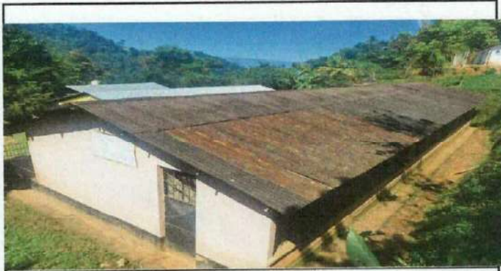
Foto 4: el entechado de las aulas presentan goteras.
