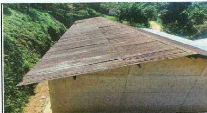
Foto 3: las láminas de este módulo 1 necesita reparación
