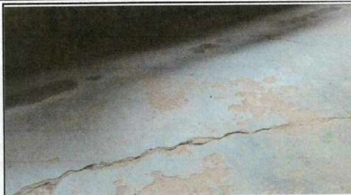
Foto 2: existen grietas en los pisos de cada aula
