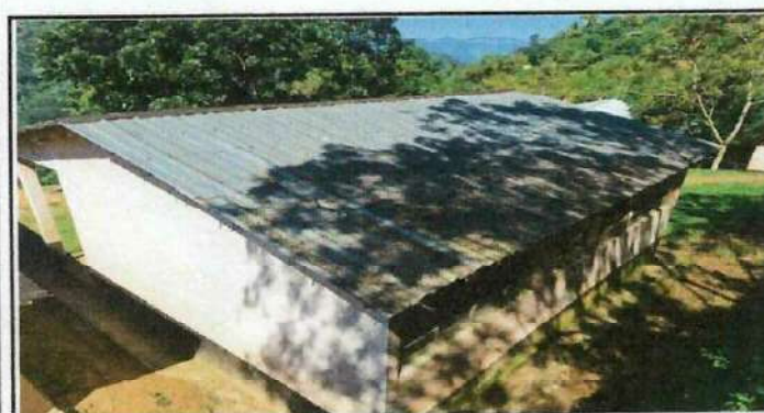
Foto 5: esta aula del módulo 2 presenta deterioro en el entechado
